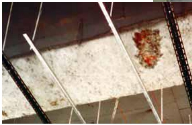
Rivestimenti in amianto spruzzato
